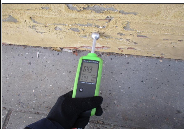
Billede 1: Måling af fugtøgning i murværk ved boliger fra 1986
