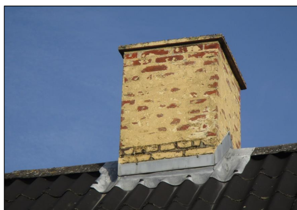
Billede 2: Begyndende nedbrydning af overflade i skorsten
